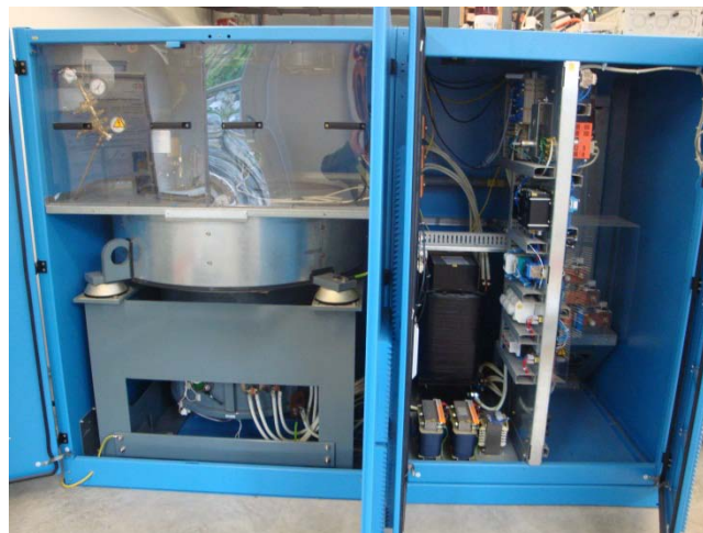
Abbildung 3-1: Schwungmassenspeicher Pb6 der Fa. Piller am EFZN (600 kW für 10 s). Auf der rechten Seite befindet sich im Wesentlichen die Wechselrichtereinheit, links ist die Schwungmasse mit dem auf der gleichen Achse befindlichen Generator zu erkennen.
